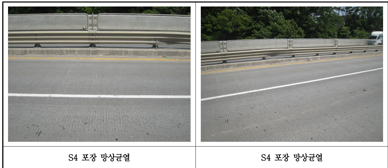
【사진 3.3.18】 교면포장 손상현황(계속)
